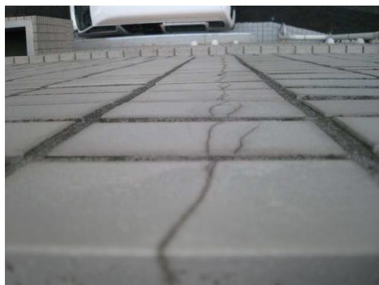
●外壁（タイル）クラック
