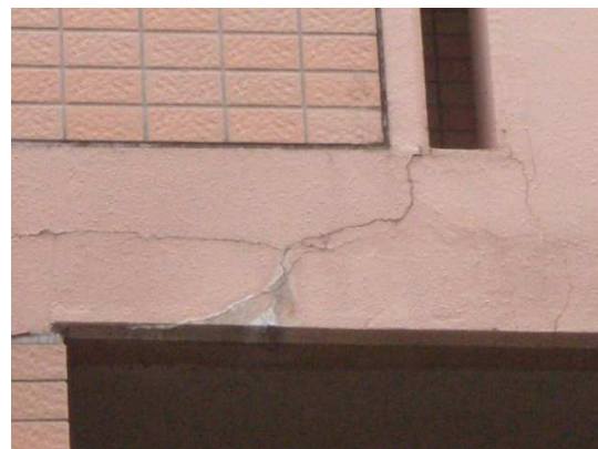
●外壁（塗装）クラック
