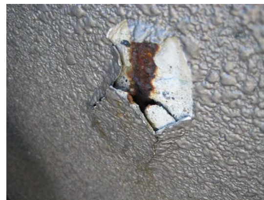
●鉄筋が露出した状態（爆裂）
