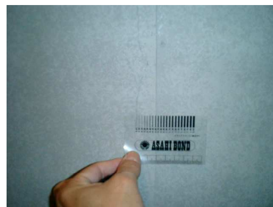
●クラックスケールでひび割れの幅を計ります。
