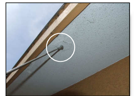
●ひさし裏の爆裂（鉄筋が錆びると体積が膨張してコンクリート・モルタルを押し出している状態）小さな劣化も見逃しません。
