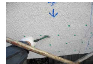
●ハンマーで塗装面のモルタル浮きを調査しているところです。
