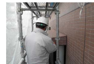
●足場解体前検査にとどまらず、工事中は、日頃施工のチェックや検査をし是正箇所があれば手直しをしていきます。
