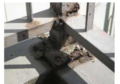
鉄部のさび・腐食
