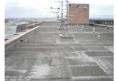
劣化しているアスファルト防水
